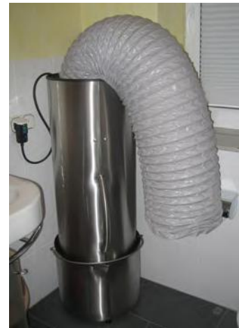
Bild 5 AirClean mit Ausblasöffnung in die Ecke gedreht
